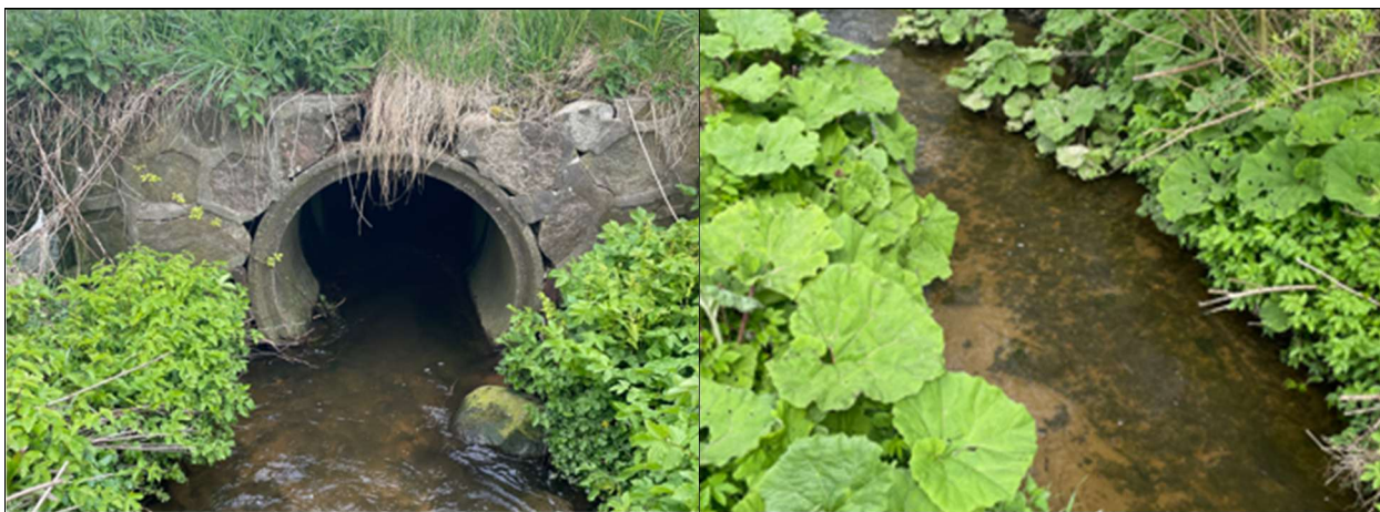
Figur 5 Venstre: Rørunderføring der er en spærring for fisk, pga. røret ligger højt i vandløbet. Højre: God gruset bund, mangler dog variation med skjul til fisk ved bl.a. skjulesten eller dødt ved.
