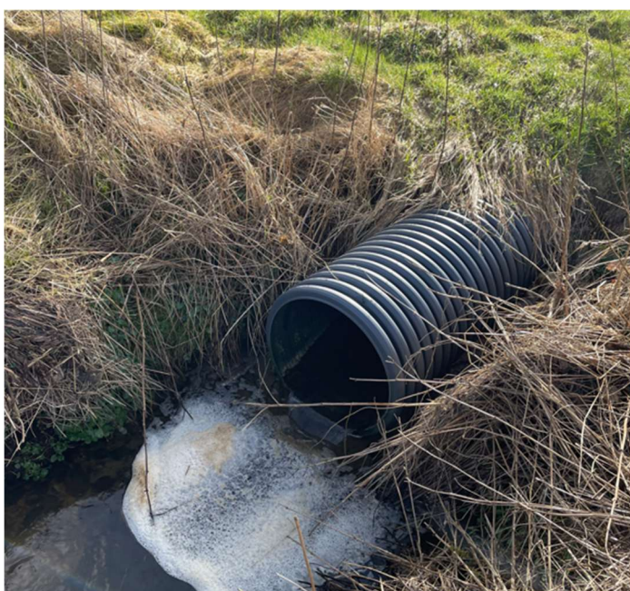
Figur 9 - Størt ud af eksisterende rørunderføring i st. 702-705 ved Lintrup Nørrebæk
